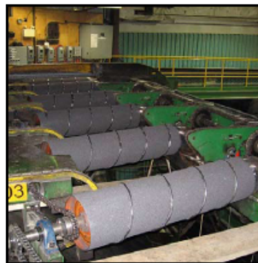
Drivrullar med beläggning och spiralinfodring.
