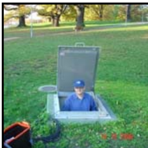
Fjärrvärmekammare utanför Råsunda fotbollsstadion
