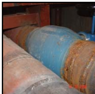
Korroderade fjärrvärmerör. Fram- och returledning
