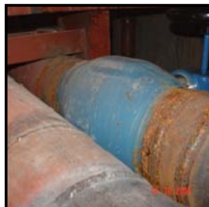
Korroderade fjärrvärmerör. Fram- och returledning
