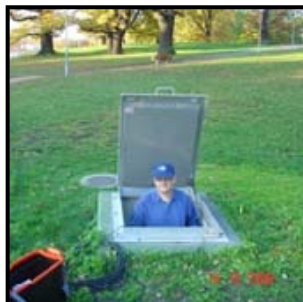
Fjärrvärmekammare utanför Råsunda fotbollsstadion
