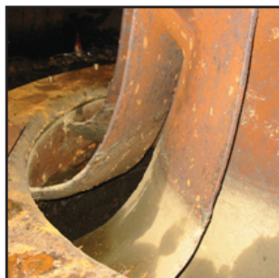
Skadat och slitet löphjul
