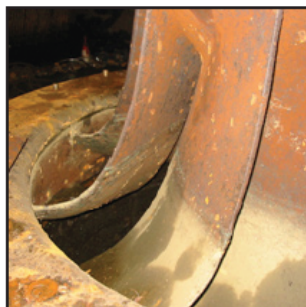
Skadat och slitet löphjul
