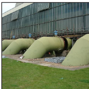
Storleken på pumparna kan föreställas med tanke på inloppsrören
