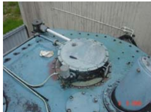
Läckage från lindning- kopplarens packning.
