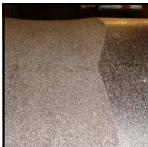
Viraskadorna framträder tydligt efter blästring.
